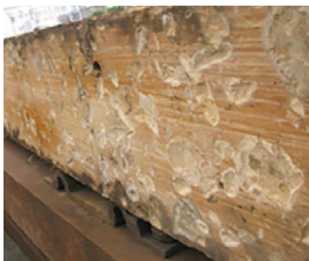
Abb. 3: Kontaktfläche Schotter einer FFU 74-Schwelle Quelle: [6]
